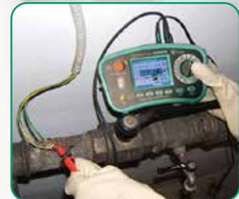
Continuity check of equipotential bonding
