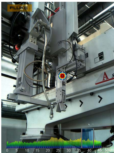
Detectie van persluchtlekage in industriële machines
