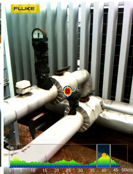
Détection de fuite sur un pipeline
