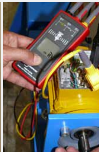
Controle van motorrotatie voorafgaand aan aansluiting
